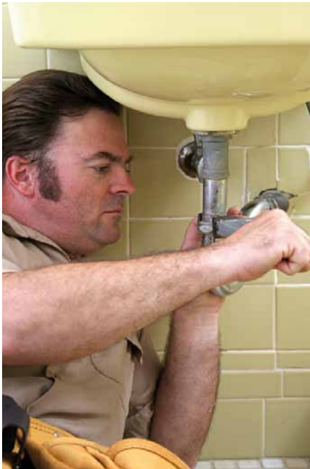
Unsachgemäße Reparatur: Bevor man Rohrschäden verursacht, sollte besser ein Fachmann beauftragt werden.
